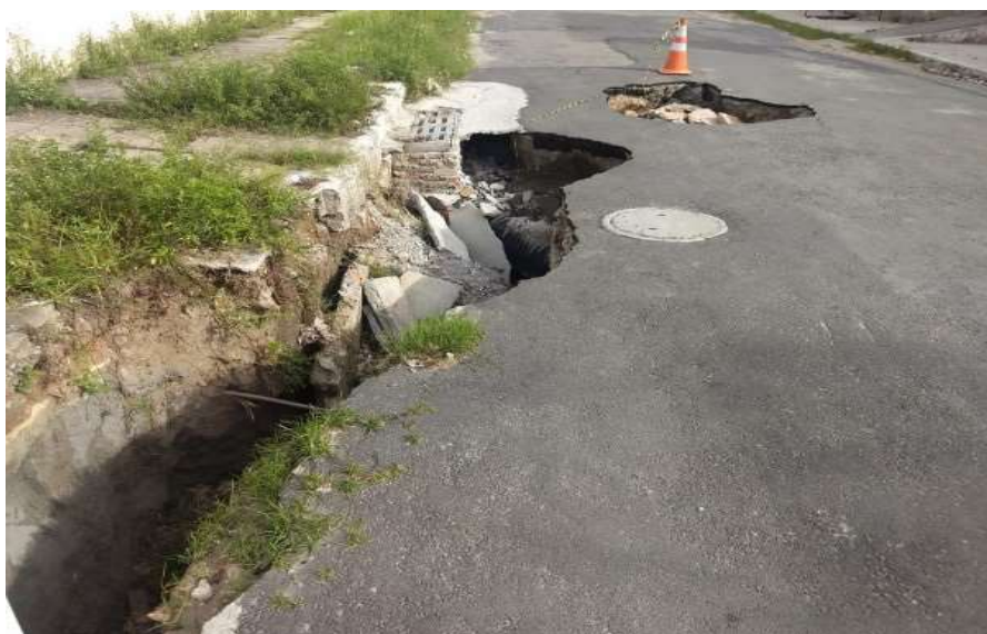
Figura 3: Fotos dos buracos nas ruas de Maceió/AL
