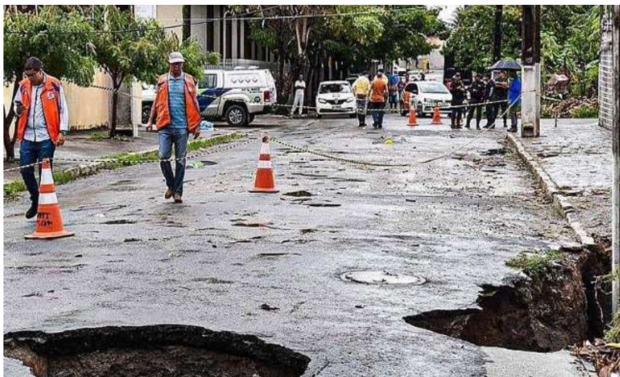
Figura 4: Fotos dos buracos nas ruas de Maceió/AL
