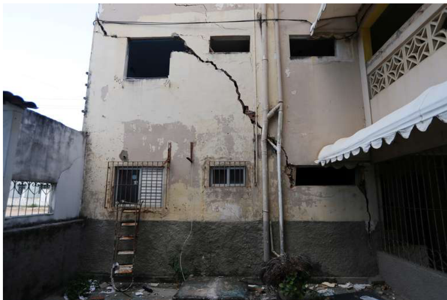
Figura 2: Fotos das fissuras em imóvel em bairro atingido, Maceió/AL
