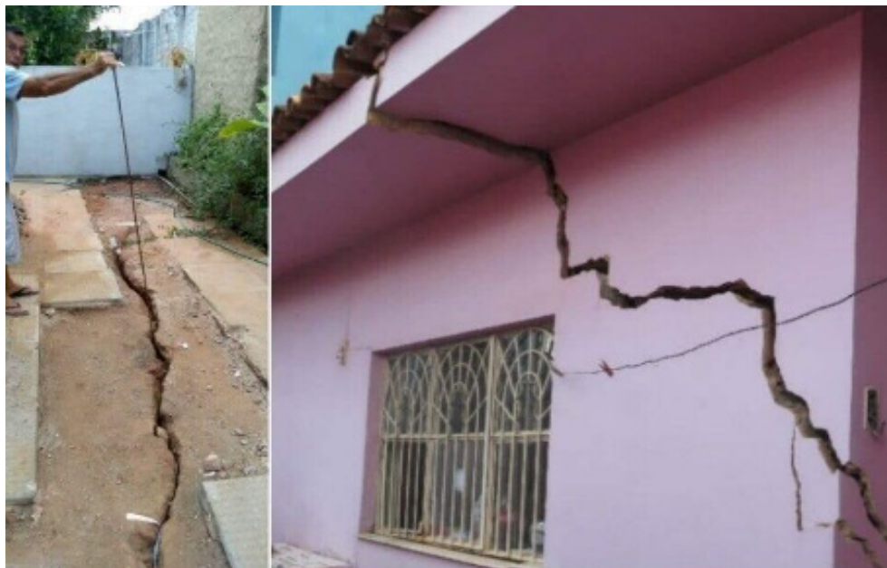
Figura 1: Fotos das fissuras em imóvel em bairro atingido, Maceió/AL
