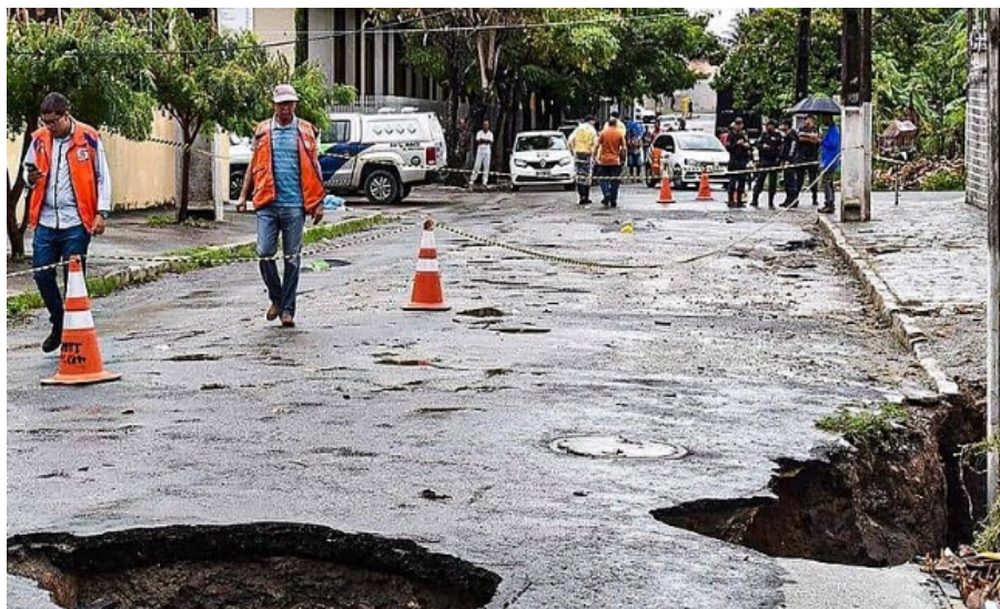
Figura 4: Fotos dos buracos nas ruas de Maceió/AL
